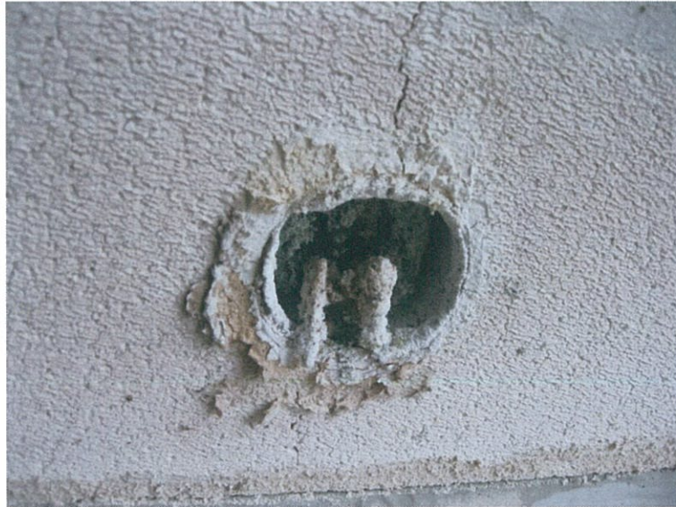
圖 23 測試後試件二向火面的詳細狀況圖
