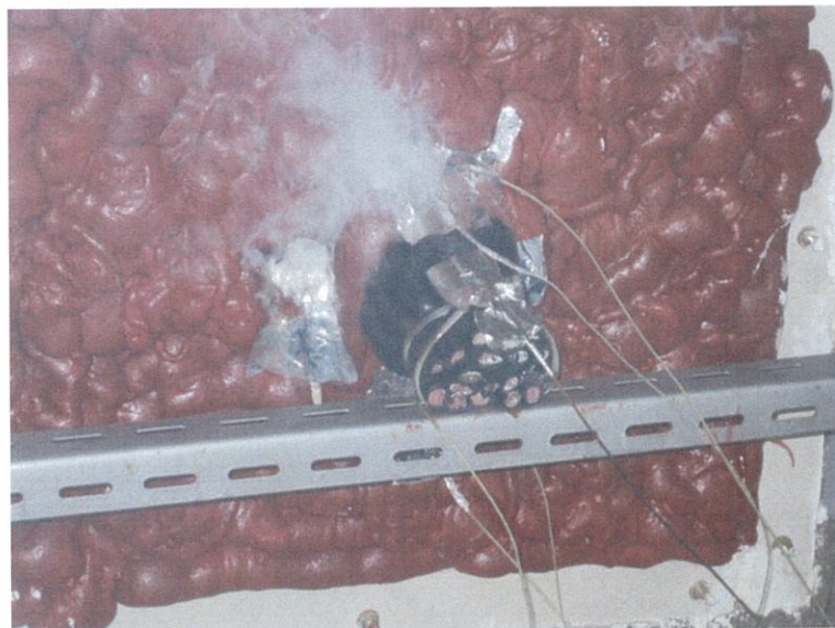
圖 12 試件背火面煙氣溢出情況
